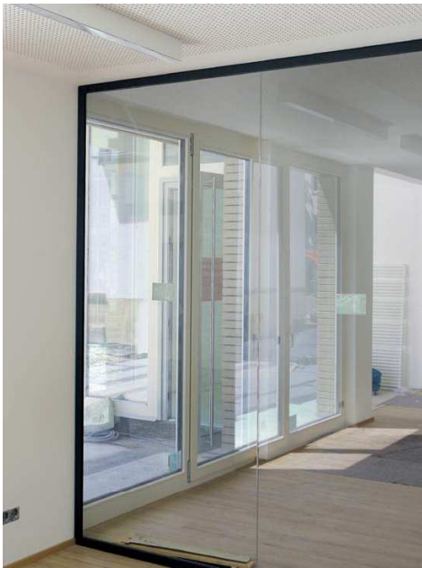
Noch stehen die Arbeiten zum Innenausbau vor dem Abschluss, die Räume zeigen jedoch jetzt schon ihren Charakter der Ruhe mitten in der Stadt.
